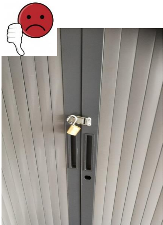
Exemple de mauvaise pratique Armoire non sécurisée
